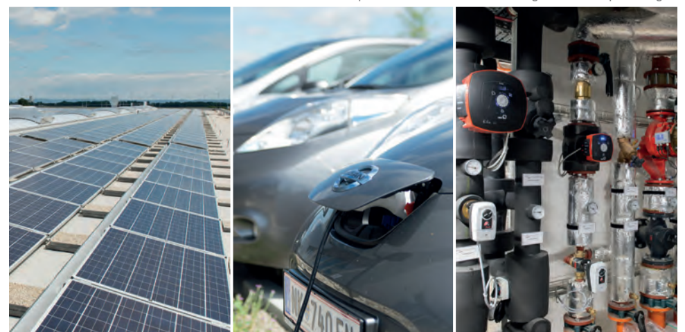
Elektroautos als Firmenfahrzeuge, Photovoltaikanlage, Heizung und Kühlung mittels Wasser-Wasser-Wärmepumpe.
